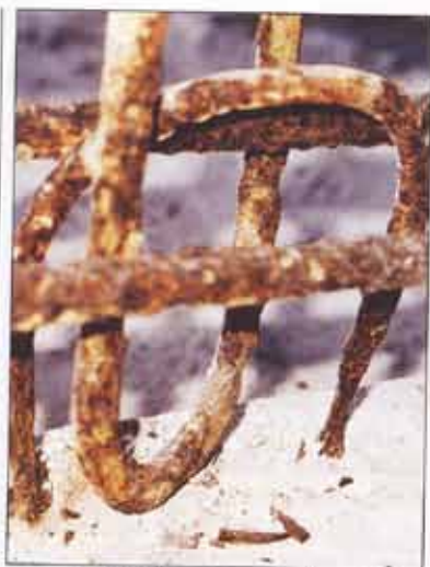
Kraftiga korrosionsskador på armeringsöglor för upphängning av balkongplatta samt på sidoväggens bärande armering i underkant.
